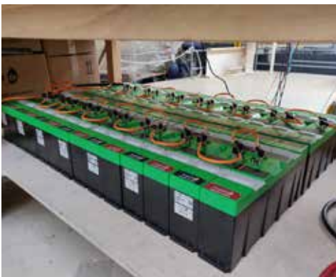
boven: Proefopstelling van de 350 V DC accubank, de polen van de individuele accu's zijn met platen doorverbonden. De oranje kabels verbinden de elektrische componenten met elkaar
